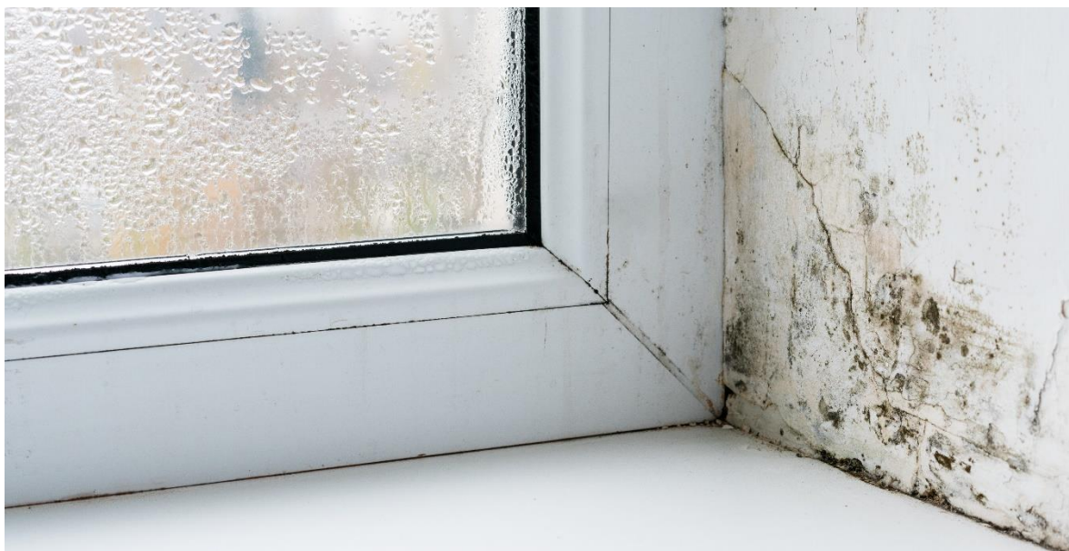
Abbildung 1: Schimmelbefall in der Wohnung
